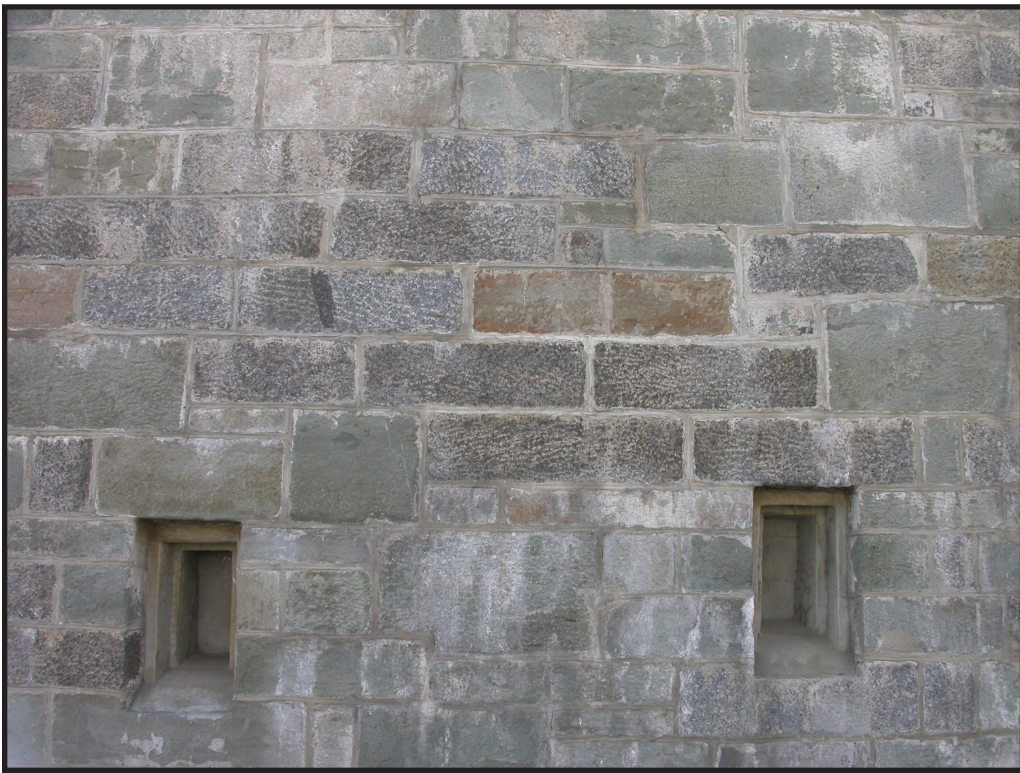
Remplacement de blocs de grès de Sillery par du granit de Rivière-à-Pierre et de calcaire de Saint-Marc-des-Carières.
