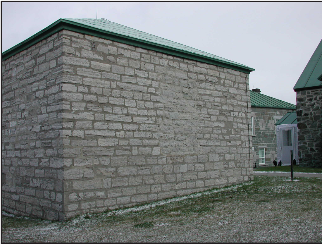
Mur arrière de l’Ancienne Tonnellerie (16, A-12) construit en (1839-1857) en calcaire de Beauport et rénové en 1930 (ou 1949) avec des pierres de calcaire de Château-Richer.
