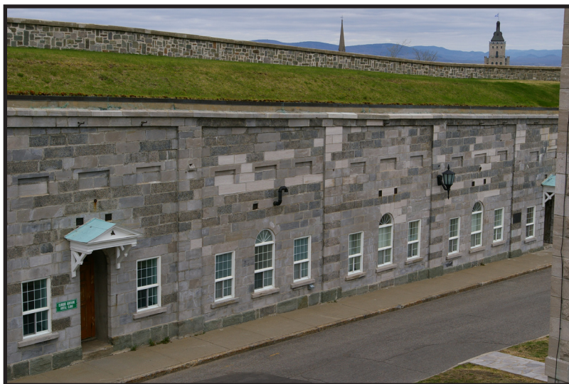
Casemates dont le parement en calcaire de Pointe-aux-Trembles a été restauré avec des blocs de granit gris rose de Rivière-à-Pierre.
